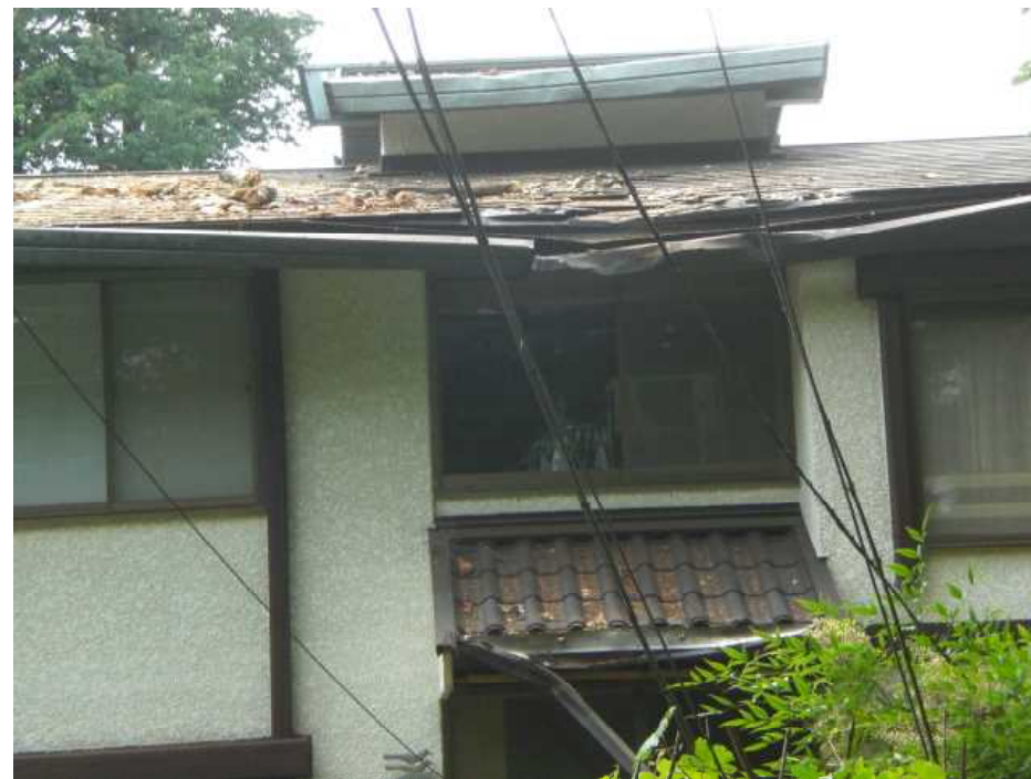
破損家屋(倒木による)
